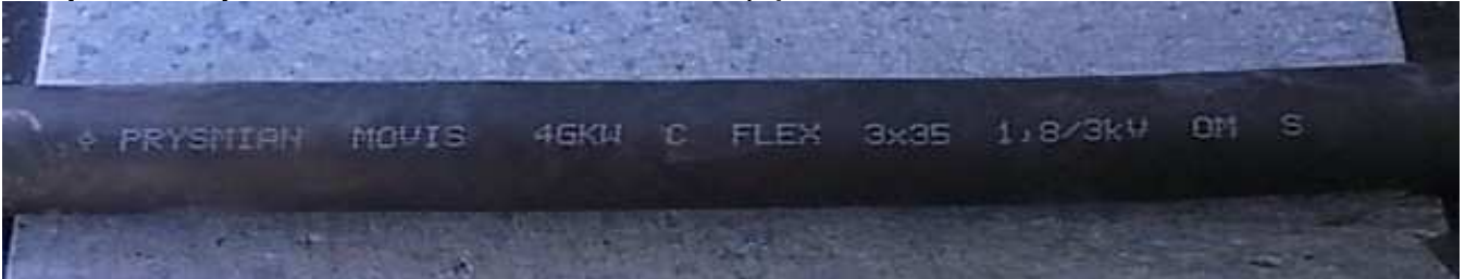
CABLE MARKING : PRYSMIAN MOVIS 4 GKW C FLEX 3X35 1,8/3 KV OM S 2015 56817 I METER MARKING
